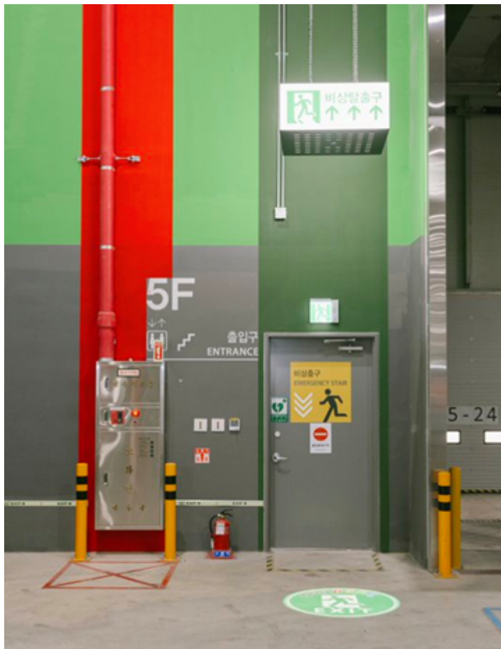
비상구는 천장과 바닥에도 녹색 등으로 표시되어 있습니다. 소화전이 있는 곳은 벽면을 붉게 칠했습니다.
