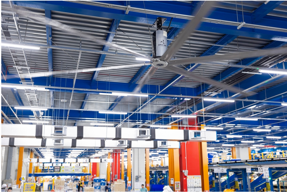
대형 실링팬 (HVLS, High Volume Low Speed fan), 쿠팡 시흥2센터
