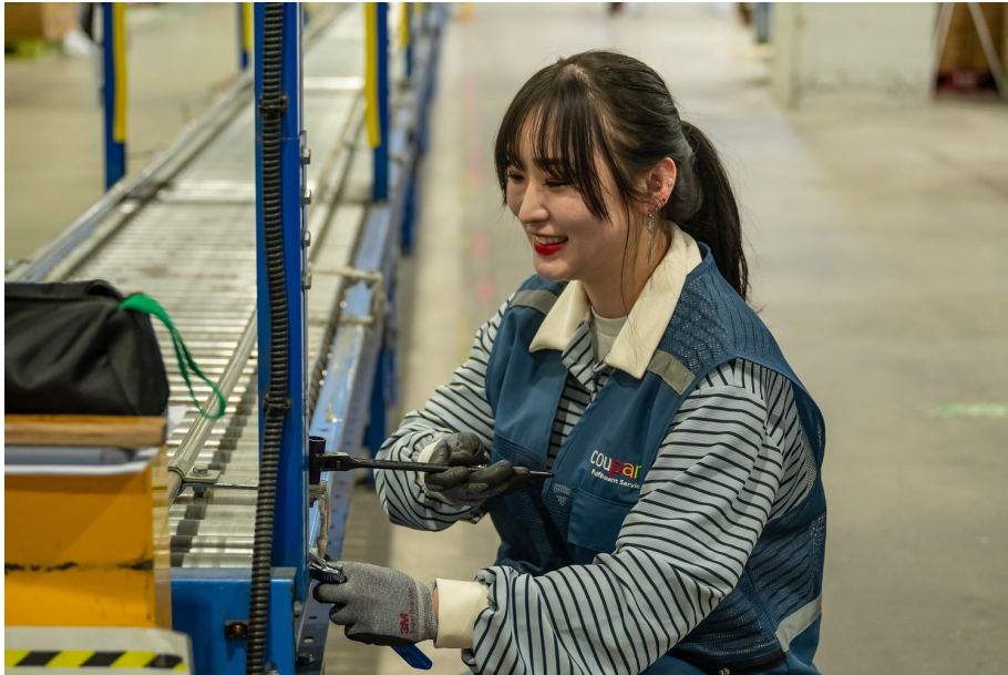
박소진 CFS 오토메이션 엔지니어가 풀필먼트센터에서 자동화 설비 롤러 컨베이어를 정비하는 모습
