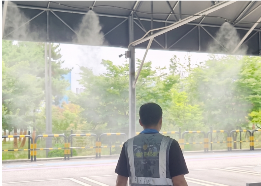
배송캠프에 설치된 콜링포그. 설명 쿠팡CLS 배송캠프에 설치된 콜링포그가 미세 물안개를 분사하고 있는 모습.
